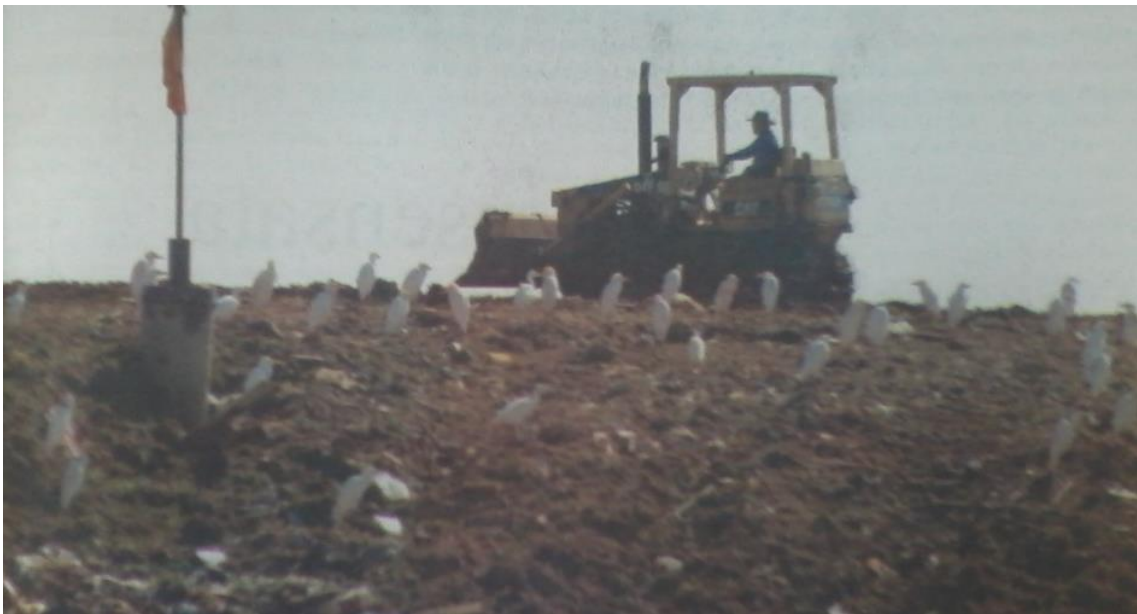
O antigo “Aterro Sanitário” está quase saturado de lixo nele depositado
